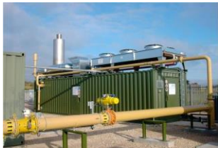
Cogénération et tri génération
