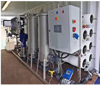
REUSE eaux traitées
